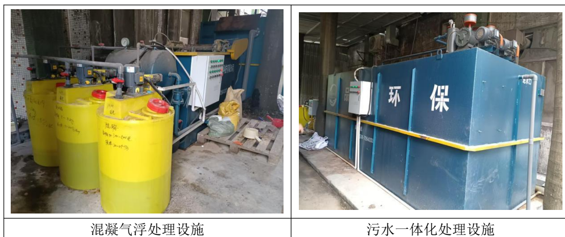
图 4.1-2 废水处理设施图片
