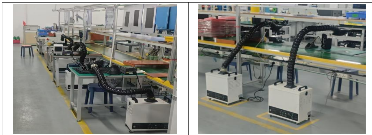
图 4.2-2 废气治理设施图片
