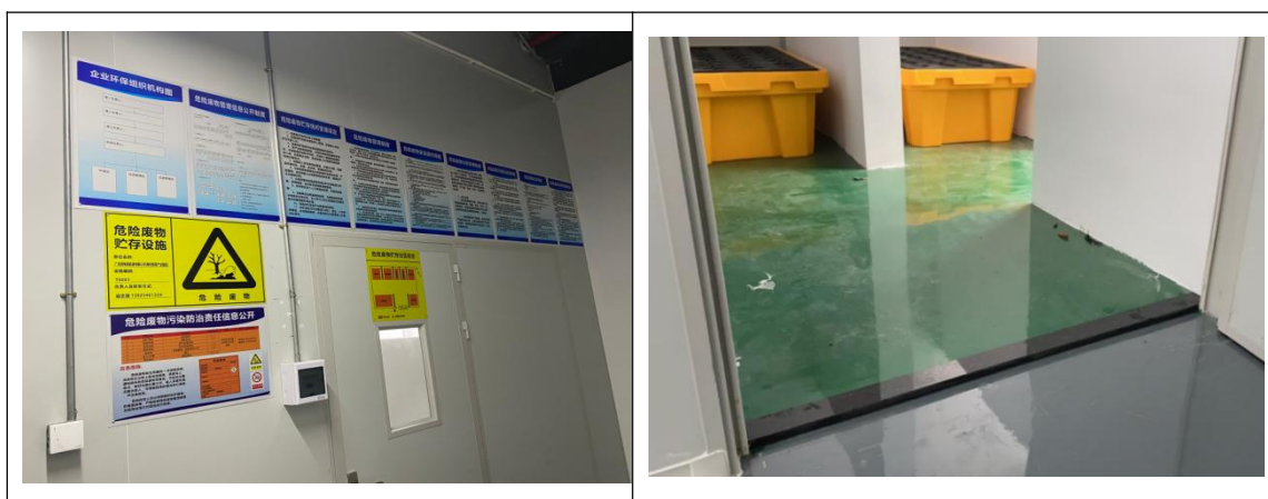
图 4.4-1 危险废物贮存场所图片
