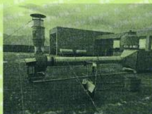
DA001 挤出、注塑工序废气处理后排放口
